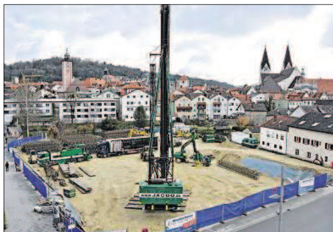
Ein riesiges Bohrergerät einer Spezialfirma aus Niedersachsen wird in den kommenden drei Wochen in der Spitalstadt im Einsatz sein. 160 Betonpfähle sollen für einen sicheren Stand des künftigen Hotels sorgen.
